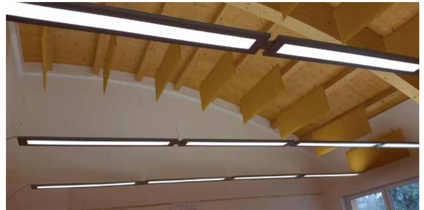
Scuola Primaria, Vezzano TN (Italy) - Product: BAFFLE
